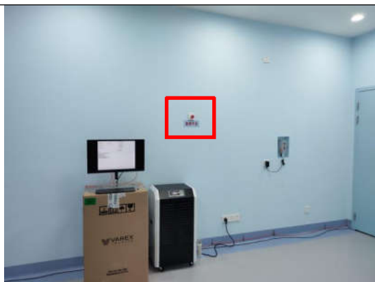
机房内北墙紧急止动及中文标识
