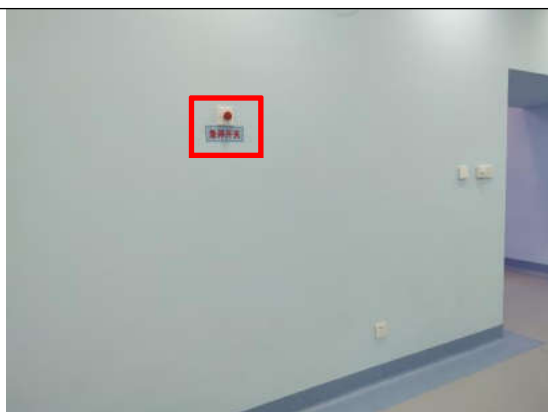
机房内西墙紧急止动及中文标识
