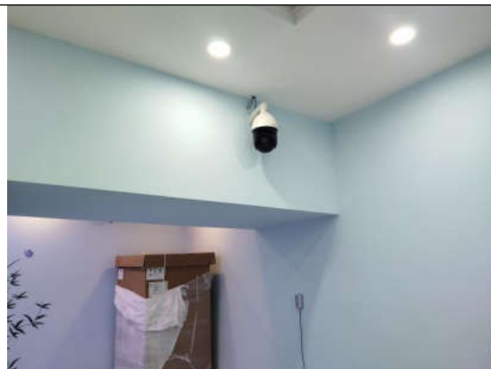
机房内视频监控
