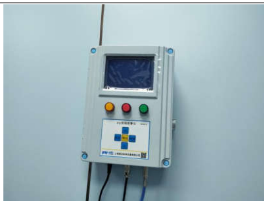
控制室内剂量显示
