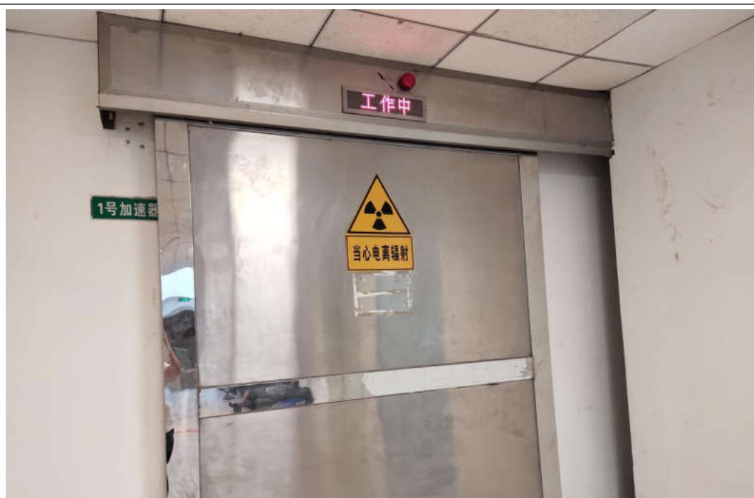
电离辐射警示标识及工作状态指示灯
