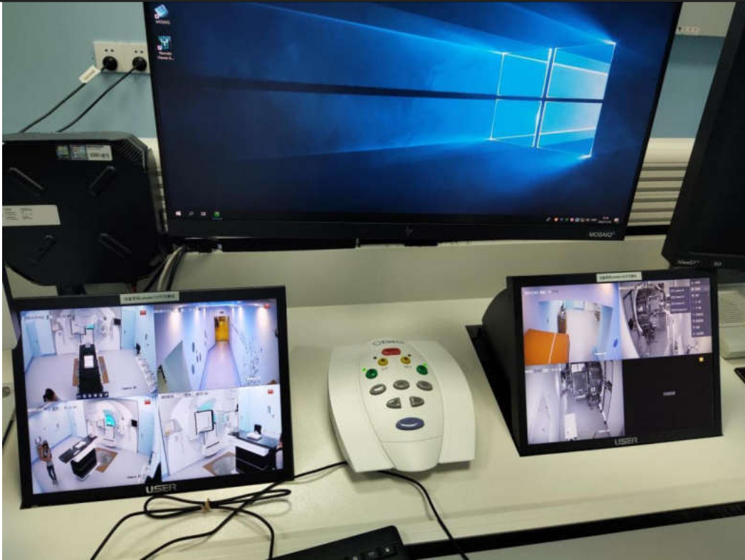
操作台监控系统
