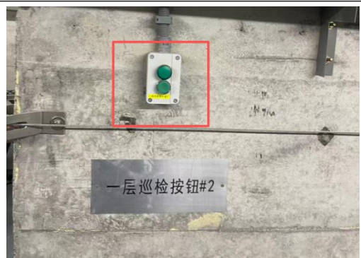
辐照室巡检按钮
