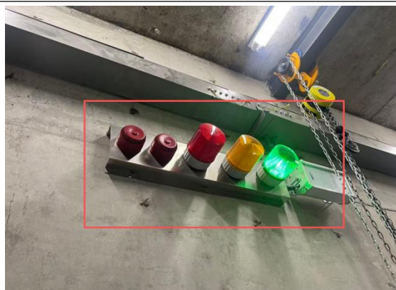
机房内灯光和音响警示信号
