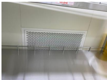
西侧墙排风口
