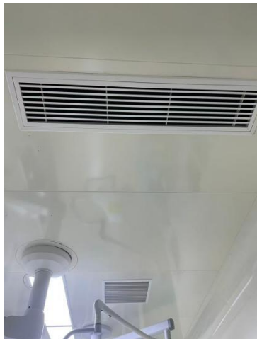
南侧中部吊顶排风口
