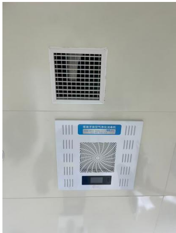
西北侧吊顶新风口
